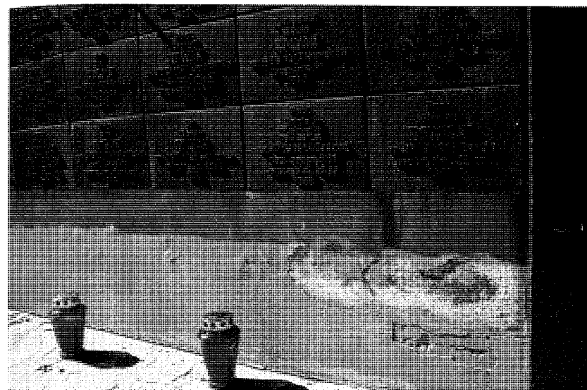
Ząb czasu nadgryza fundament. Foto L. Kasprzak
