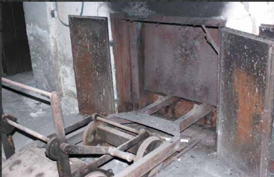
Krematorium w podziemnej części kaplicy na cmentarzu komunalnym w Fürstenbergu. Fot.: Paweł Woźniak
